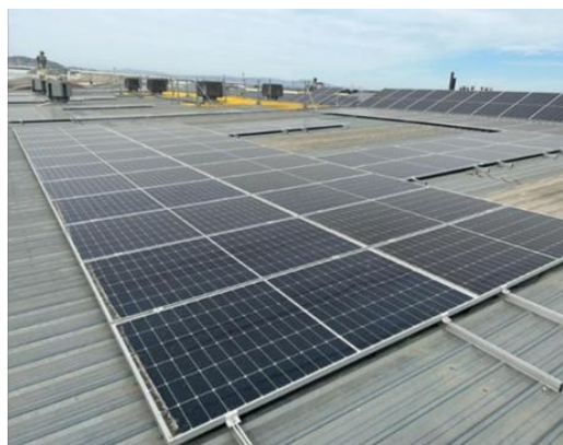
Imagen de la instalación fotovoltaica de la planta de Alacuás (Valencia)
