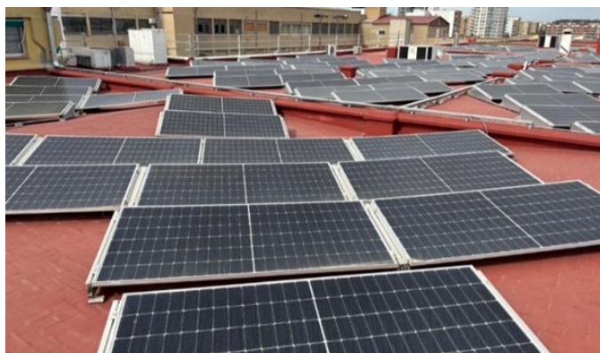
Imagen de la instalación fotovoltaica de la sede central (Valencia)
